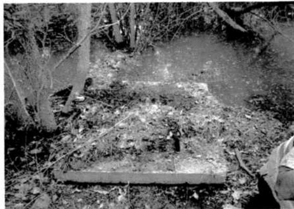
Non functional overflow spillway
