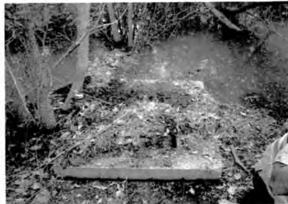
Non functional overflow spillway
