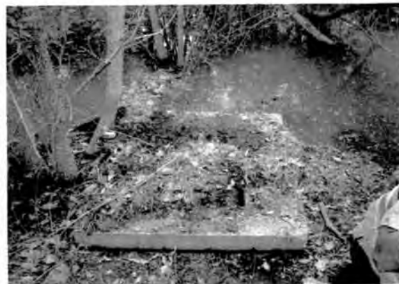
Non functional overflow spillway
