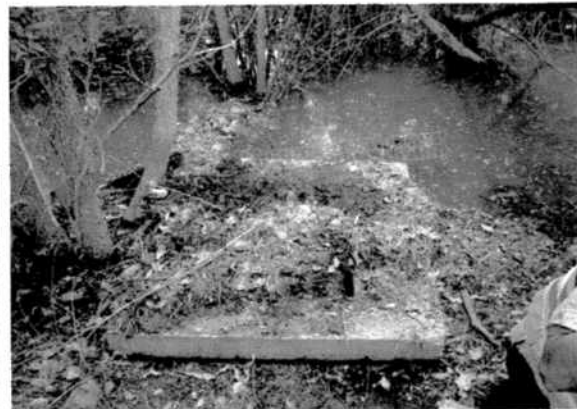
Non functional overflow spillway
